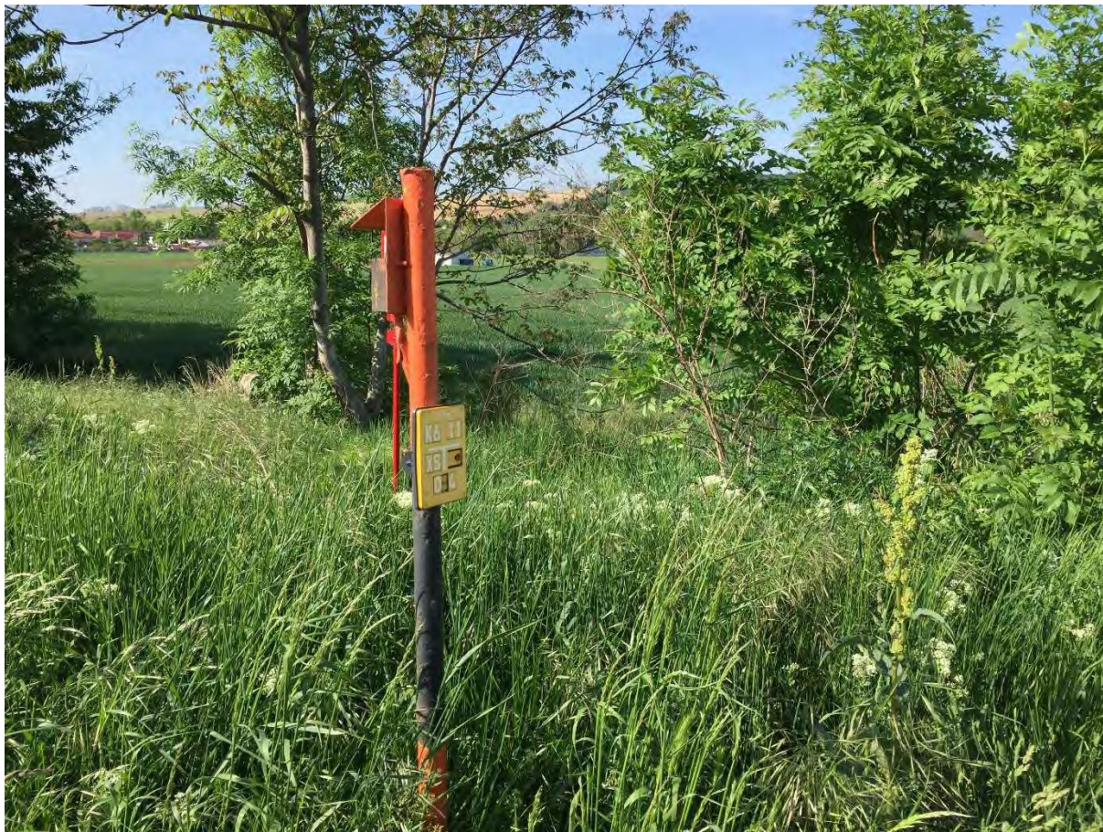
Obr. č. 10: Ochranná tyč plynovodu
